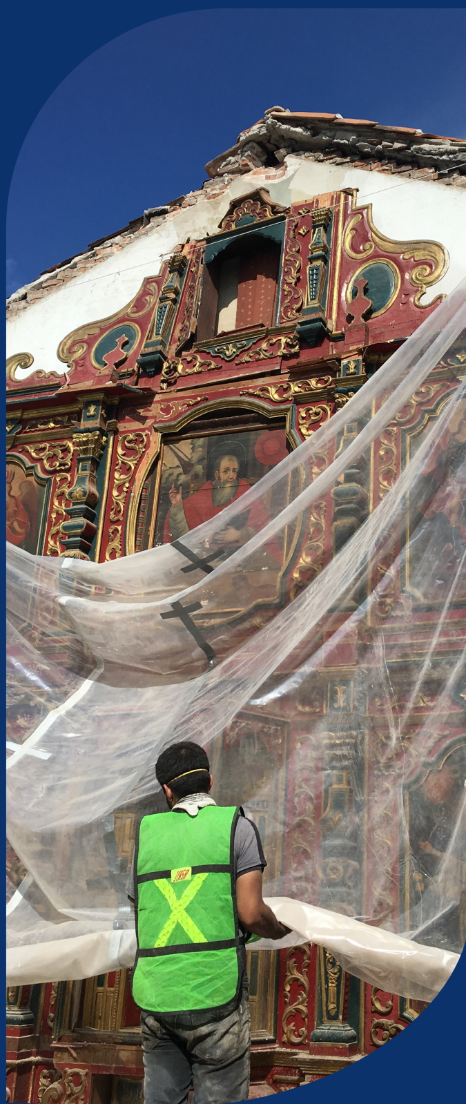
Retablo detrás de escombros en un templo colapsado, 2017. Fotografía: David Torres. SC. INAH. CNCPC.
